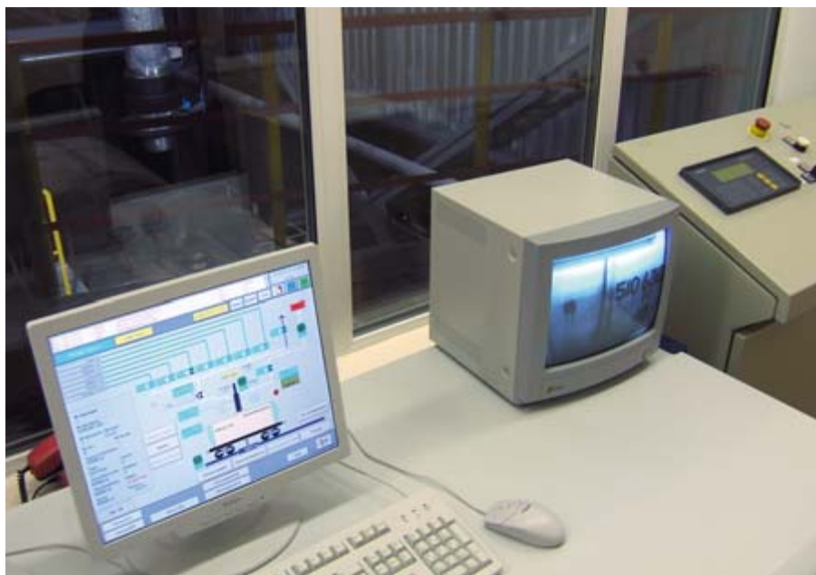
Рис. 5. Оборудование АРМ оператора
