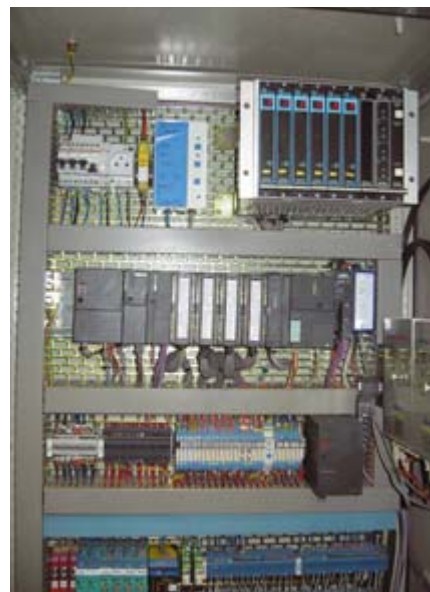
Рис. 4. Шкаф центрального контроллера А3
