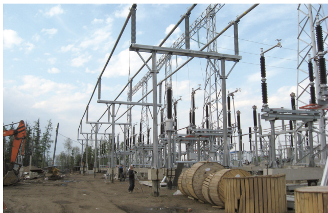
Сборные шины 220кВ
