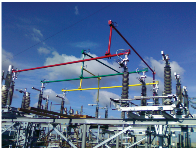
Токовая перемычка 110 кВ
