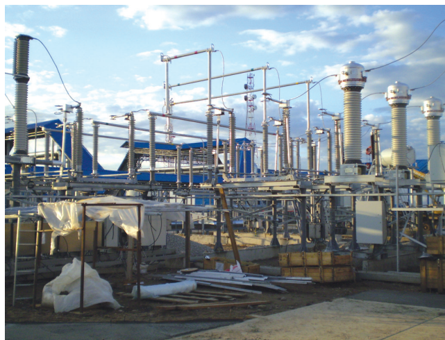
Токовая перемычка 220 кВ
